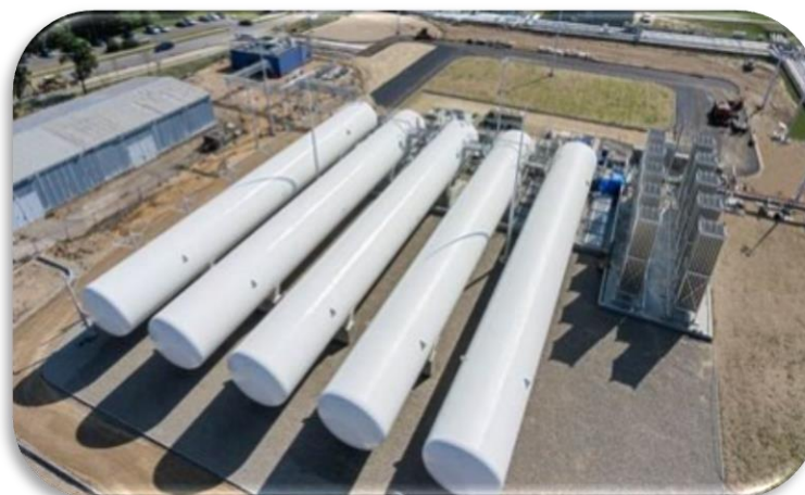
ALMACENAMIENTO DE GNL PARA ESTACIÓN DE BUNKERING
