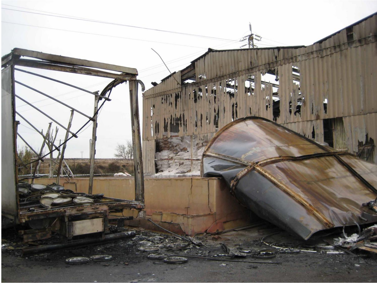
Accidente provocado por labores de Soldadura
