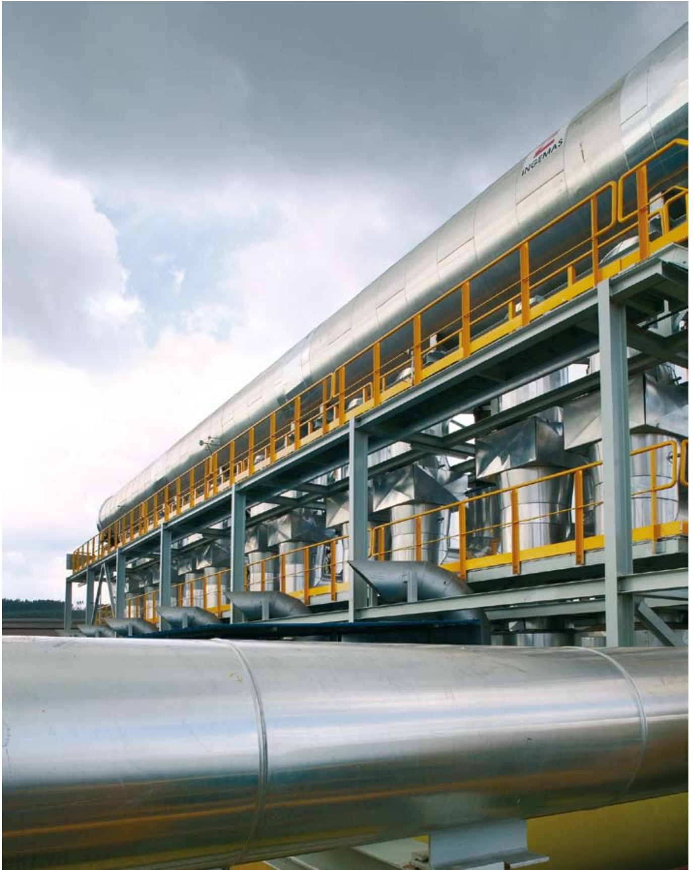
ArcelorMittal Central de cogeração SIDERGAS.
