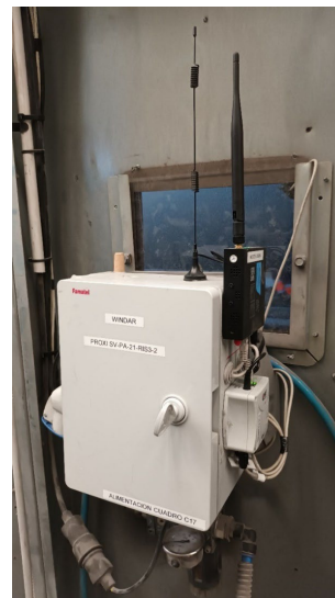
Ilustración 2 Detalle del equipo de captura de datos instalado en el lateral de la cabina
