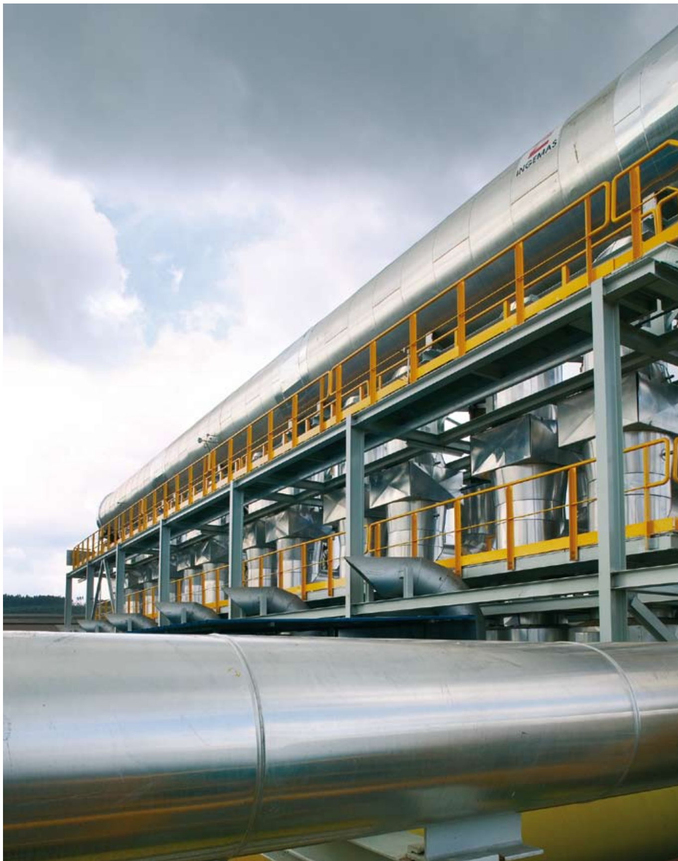
ArcelorMittal Cogeneratie fabriek SIDERGAS.
